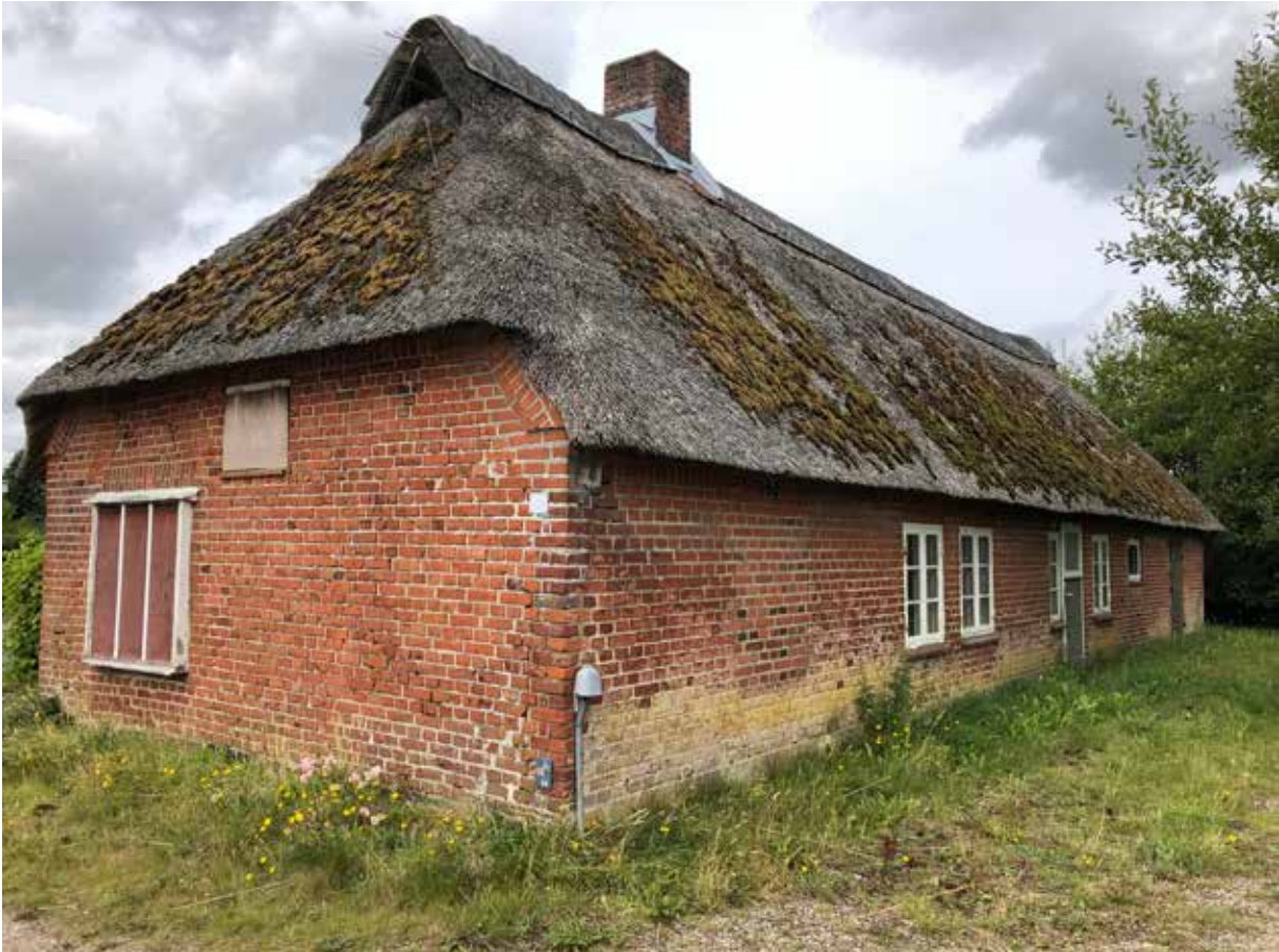
Abb. 19: leerstehendes Wohnhaus in der Straße „am Ausblick“
