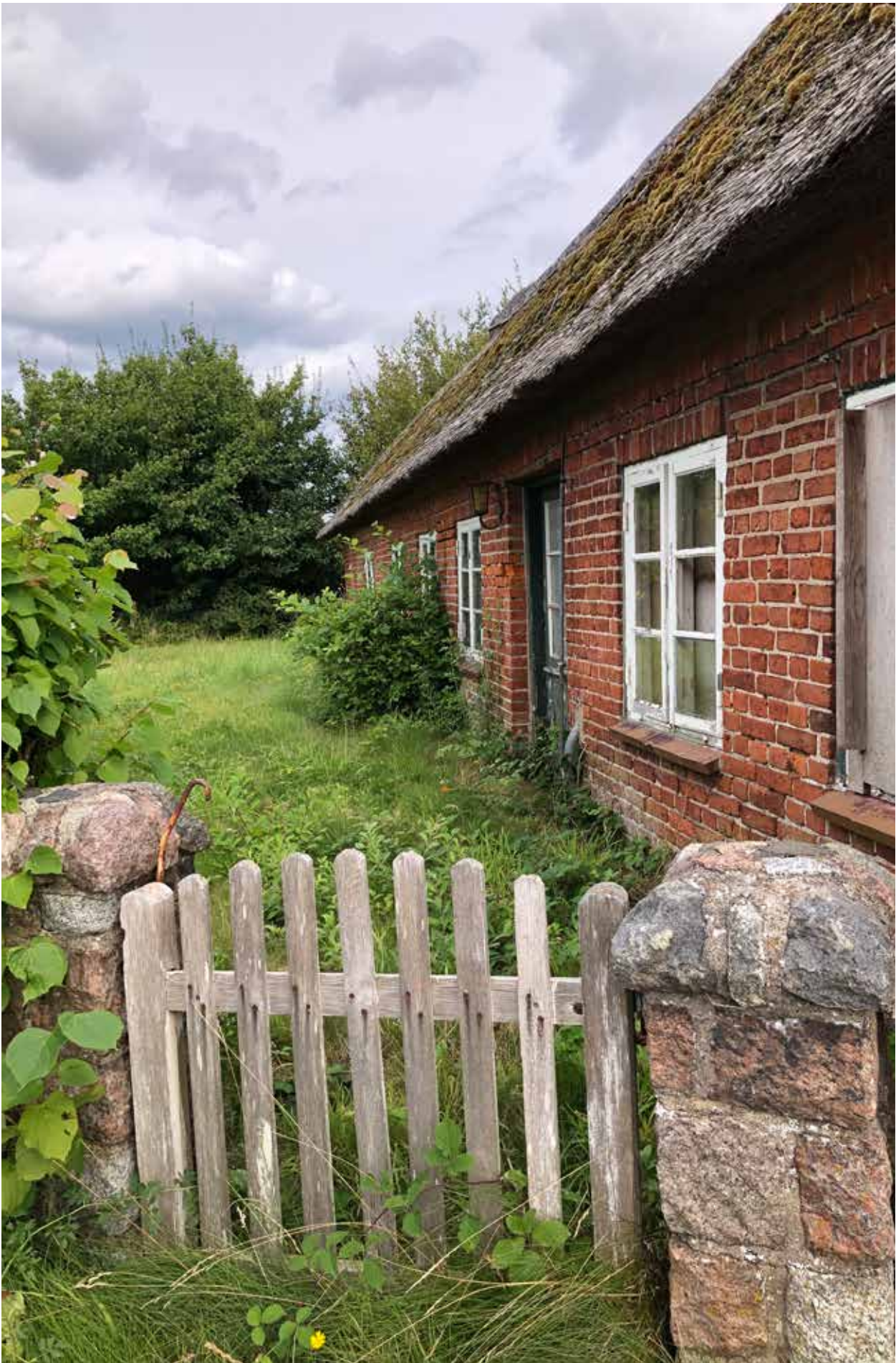
Abb. 17: Ortsbildprägendes Gebäude mit hohem Sanierungsstau in der Straße „Am Ausblick“
