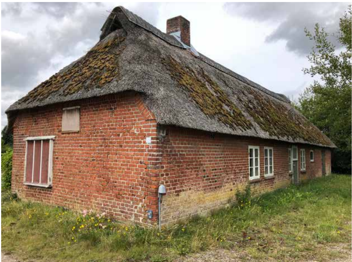
Abb. 19: leerstehendes Wohnhaus in der Straße „am Ausblick“
