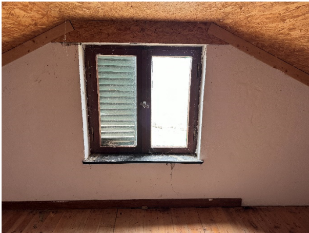
Giebfenster mit Riss in der Brüstung (12.06.2024) Dachboden mit Fußbodendielung und OSB-Platten im Bereich der Dachschrägen
