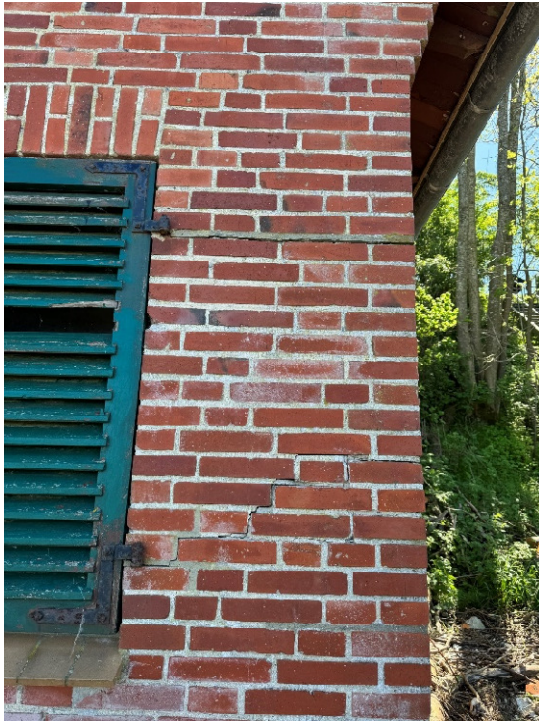
Risse in den Fugen der Vormauerschale (16.05.2024)
