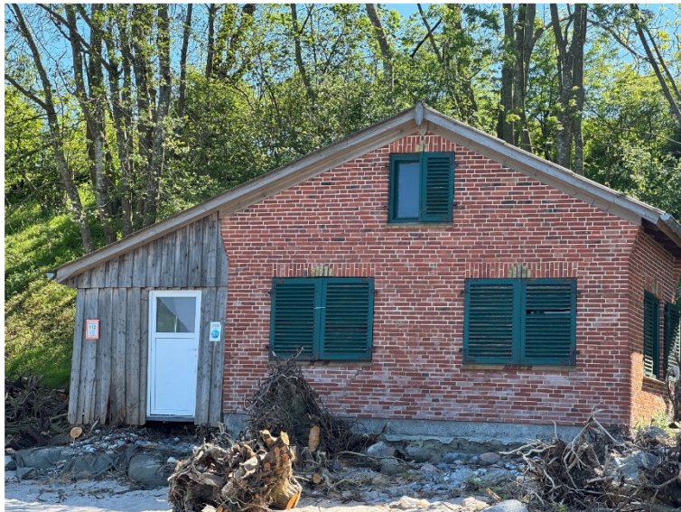
Giebelansicht Norden (16.05.2024) mit giebelseitig freigespülten Fundament
