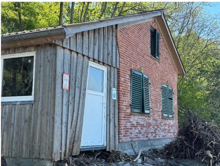
Eingangsbereich mit Schäden im Sockelbereich (16.05.2024)
