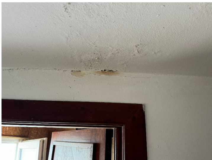
diverse Schäden an der Unterseite der EG-Decke (12.06.2024)
