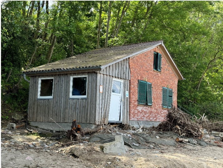
Eckansicht Nordosten (12.06.2024) mit geschädigten Anbaubereich und freigespülten Fundamenten
