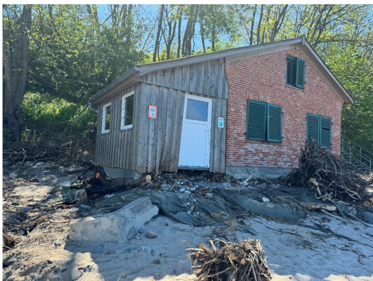
Eckansicht Nordosten (16.05.2024) – mit Schäden am Eingang
