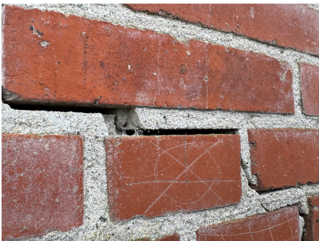
offene Fugen und Risse am Nordgiebel (12.06.2024)
